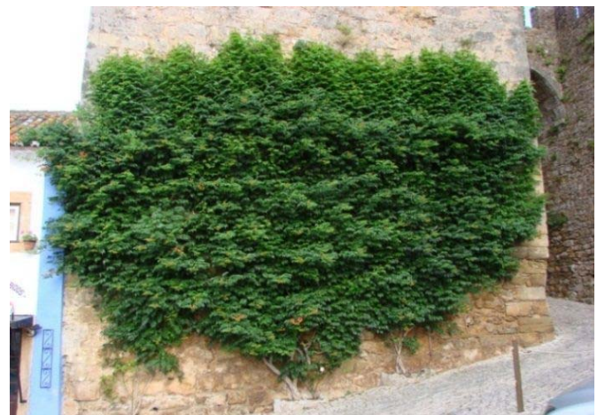
↓壁面にめり込んだ植栽 それでも青々としている
