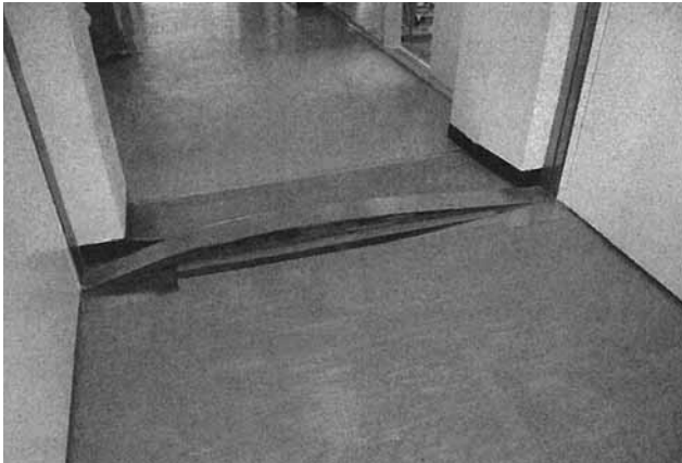
RC建物EXPJの損傷
