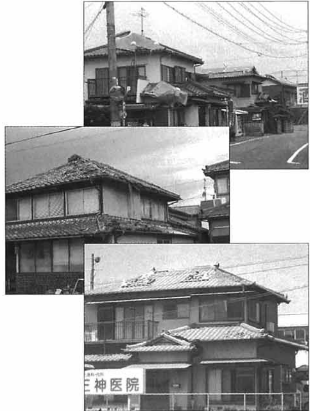
写真4 瓦屋根の被害状況
