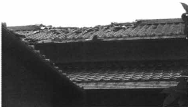
あちこちでみられた瓦屋根の被害
