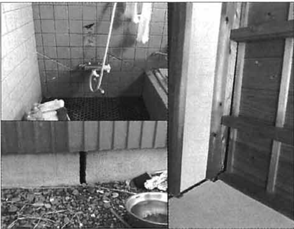
写真3 半壊した住宅の被害
