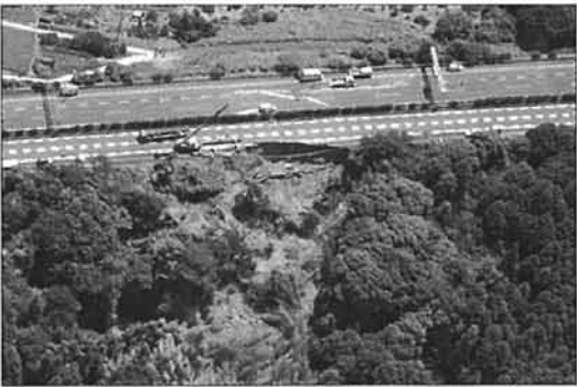
写真2 東名高速道路の盛土崩落
