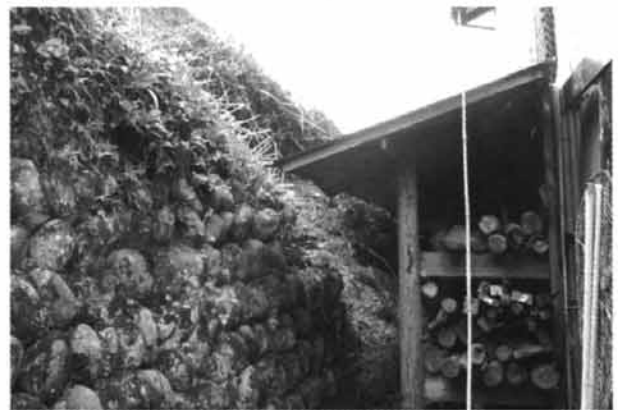
住宅横で石垣の崩壊
