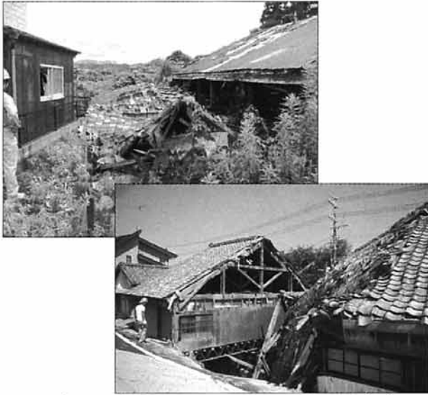
写真5 全壊した瓦工場、半壊した倉庫
