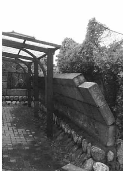
ブロック塀の転倒
