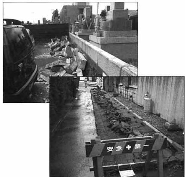
写真6 ブロック塀等の被害
