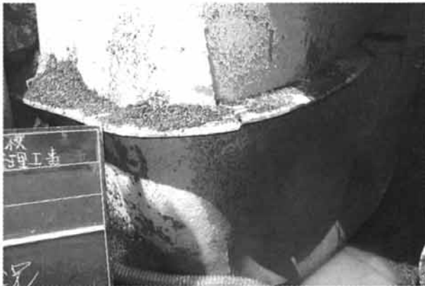
浄化槽の破損
